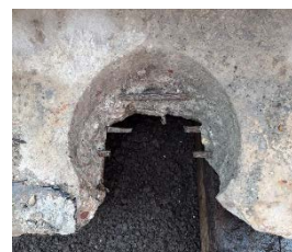
Foto-9 Beschadigde voorspanstrengen t.p.v. hijsgat
